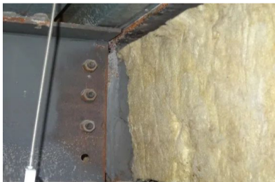
梁柱节点腹板连接质量差
