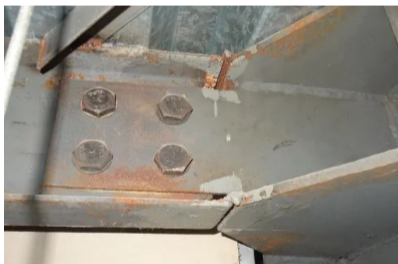
梁柱节点上下翼缘连接质量差
